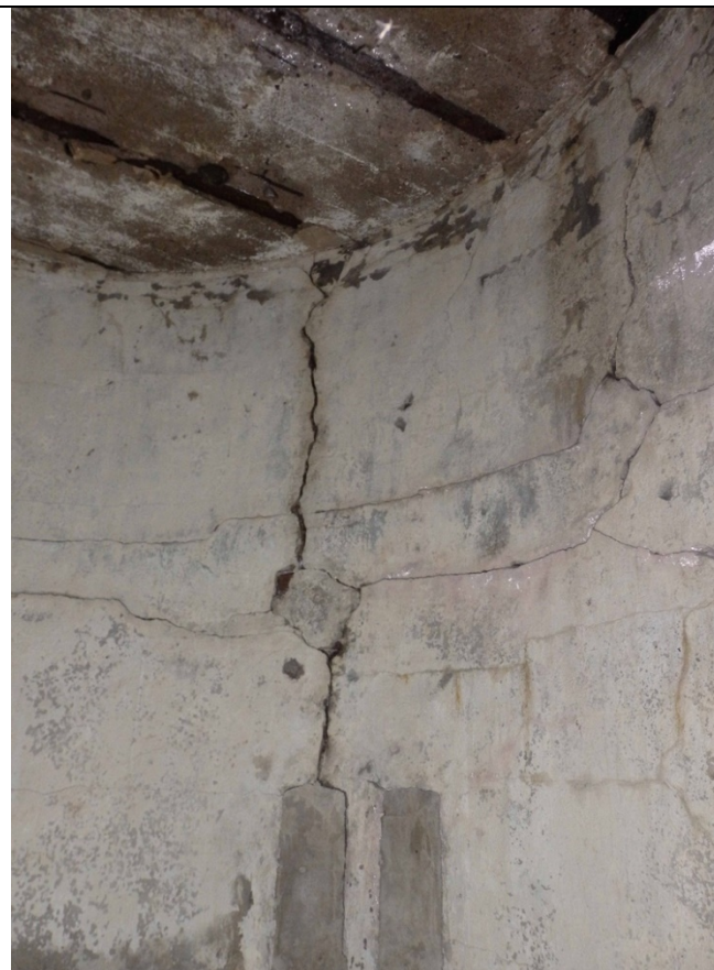
Fot. 12 Wnętrze wieży – spękania i zarysowania ścian, korozja belek stalowych stropu (stan: 12.2024 r.)
