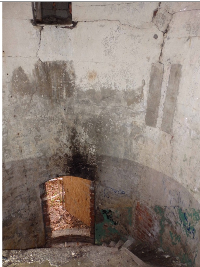
Fot. 11 Wnętrze wieży – spękania i zarysowania ścian (stan: 12.2024 r.)
