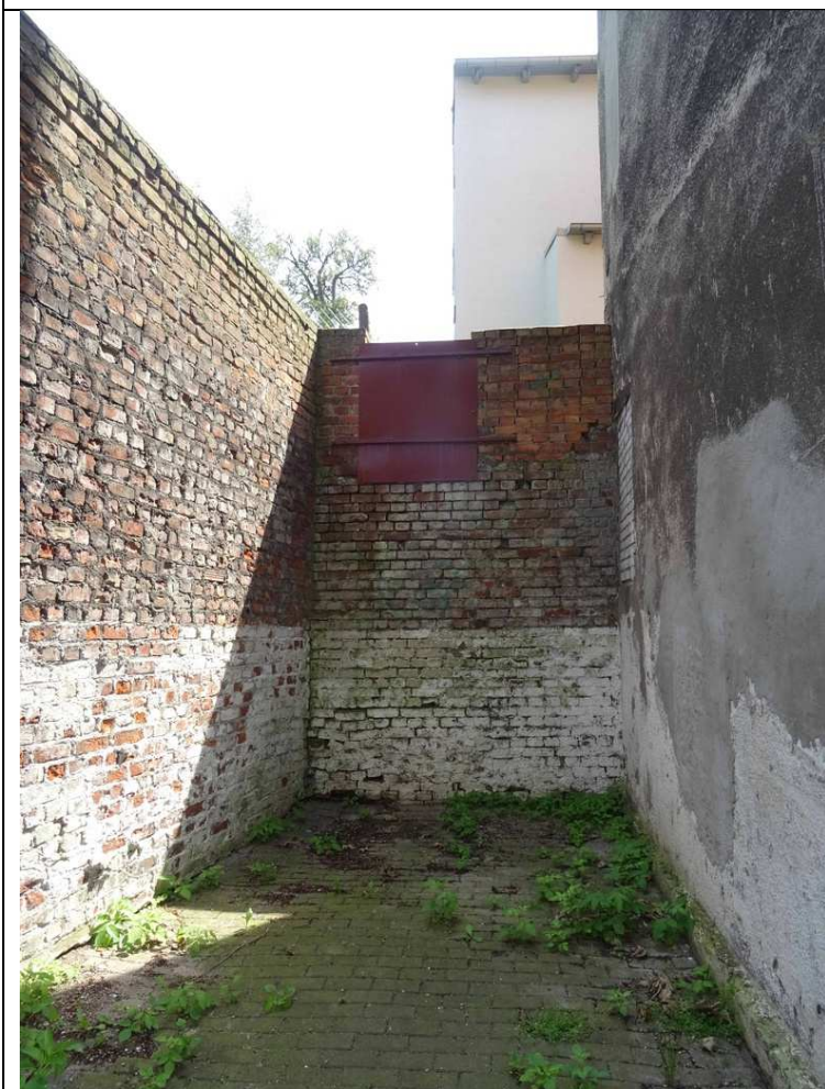
Fot. 5 Widok ogólny muru – odcinek CD i D-E. Widoczna destrukcja spoin na całości lica i znaczną w strefie korony muru.
