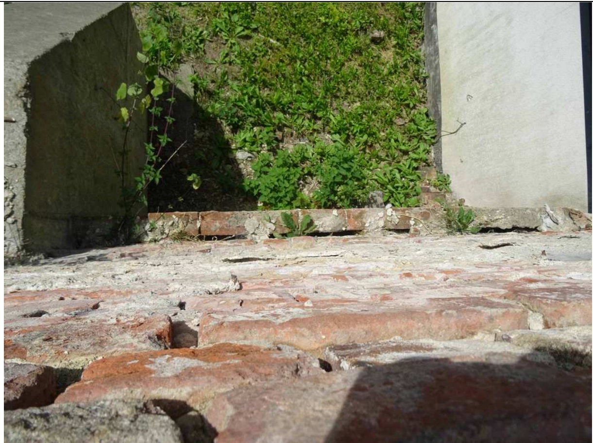
Fot. 12 Widok ściany „z góry” - odcinek A-B. Widoczna warstwa osłonowa szer. 12 cm i pustka powietrzna o szer. 5 cm.
