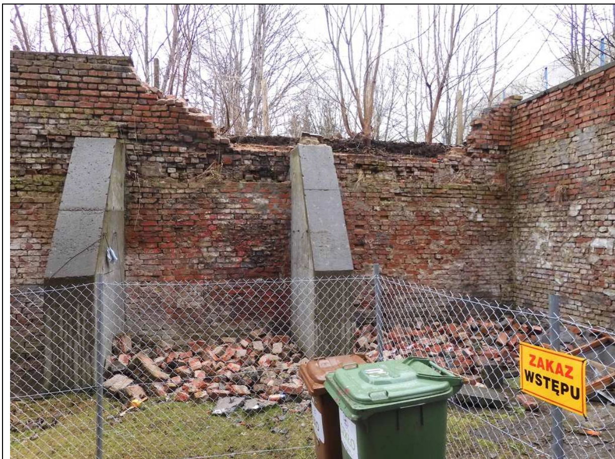
Fot. 6 Widok ogólny – odcinek B-C stan na 02.2024 r. Widoczna zniszczona partia muru, materiał leżący u podstawy muru, widoczne również strefa znaczne zniszczenie cegieł w pasie na poziomie terenu znajdującego się za murem
