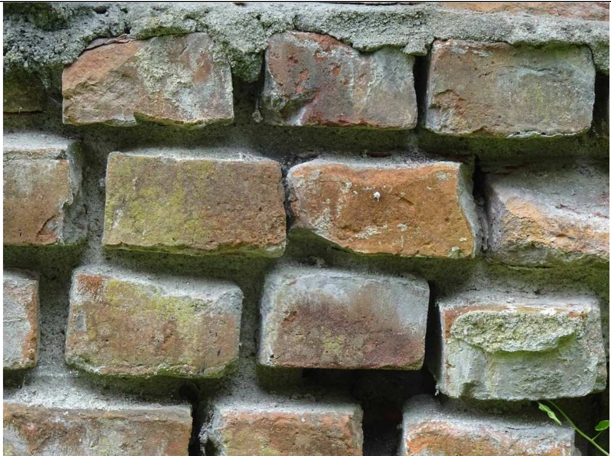
Fot. 12 Widok lica ściany od strony wschodnie muru– odcinek A-B. Widoczna wypłukana na znaczną głębokość zaprawa wapienna.
