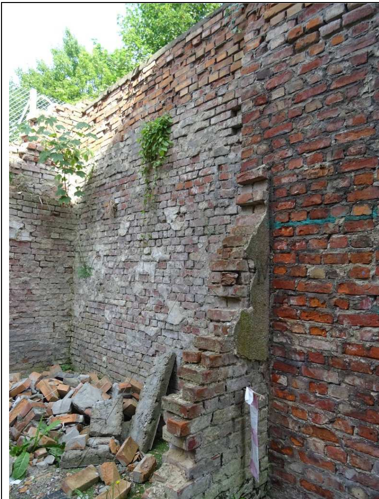
Fot. 8 Narożnik odcinków muru B-C i C-D. Widoczny materiał pochodzący z uszkodzonej ściany, widoczny również fragment ściany z rozebranego budynku. Widoczna również różnica w sposobie wykonania muru. Z lewej murowany na zaprawie wapiennej, z prawej murowany na zaprawie cementowo-wapiennej.
