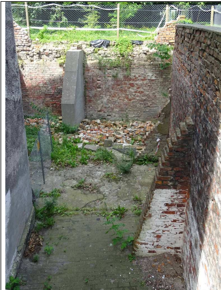
Fot. 4 Widok ogólny muru – w oddali odcinek B-C w strefie awarii, z prawej widoczny odcinek C-D z pozostałością ściany rozebranego budynku mieszkalnego i murowaną przyporą na pierwszym planie.
