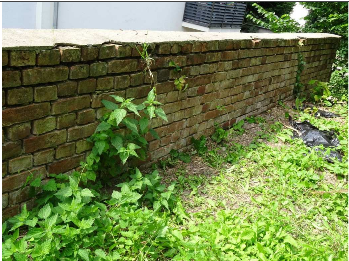
Fot. 13 Widok lica ściany od strony wschodniej za murem nad nasypem – odcinek A-B. Widoczna wypłukana na znaczną głębokość zaprawa wapienna.
