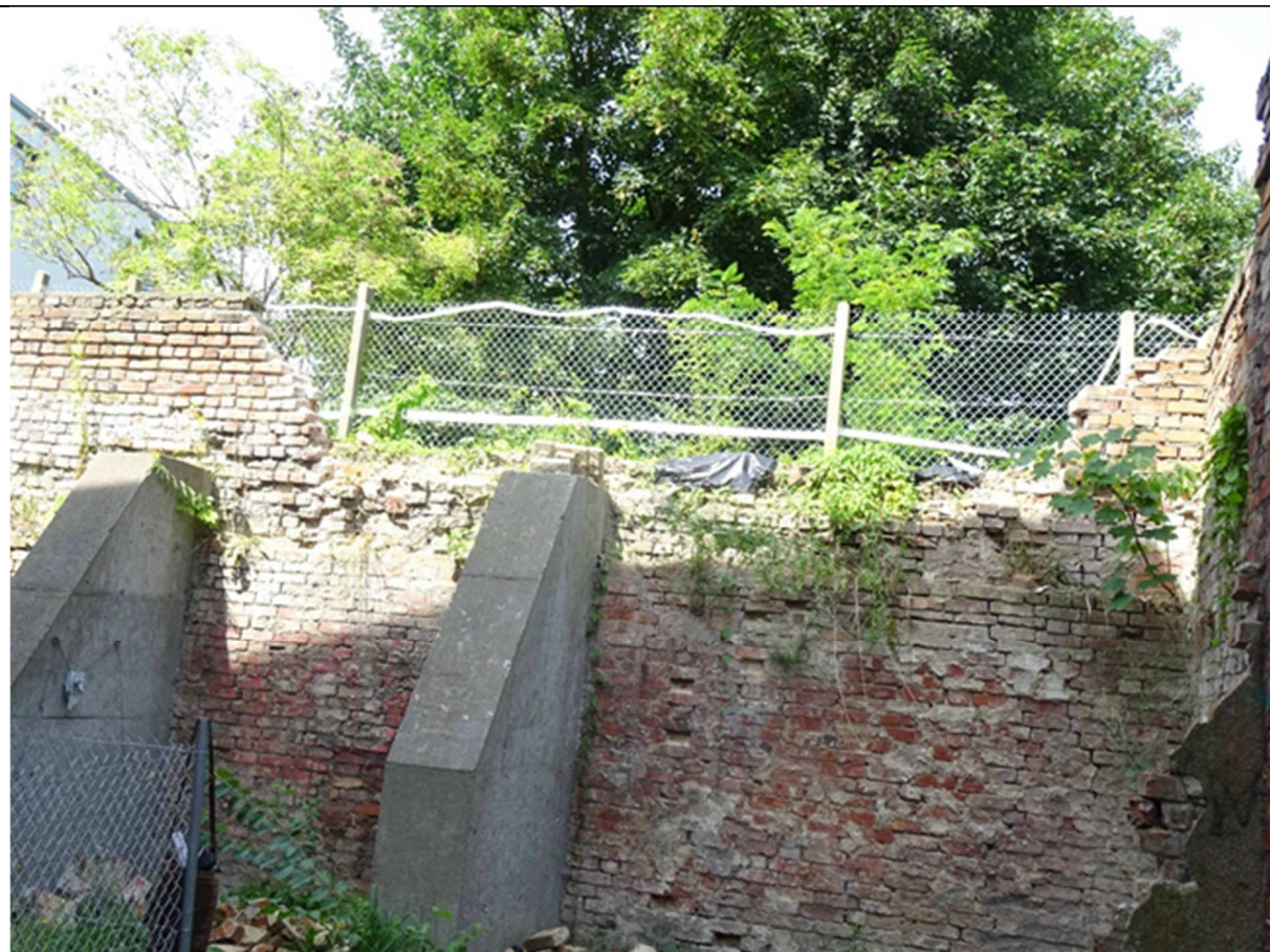
Fot. 7 Widok ogólny – odcinek B-C stan na 06.2024 r. Widoczna zniszczona partia muru, roślinność wysoka rosnąca za murem, widoczne również strefa znaczne zniszczenie cegieł w pasie na poziomie terenu znajdującego się za murem
