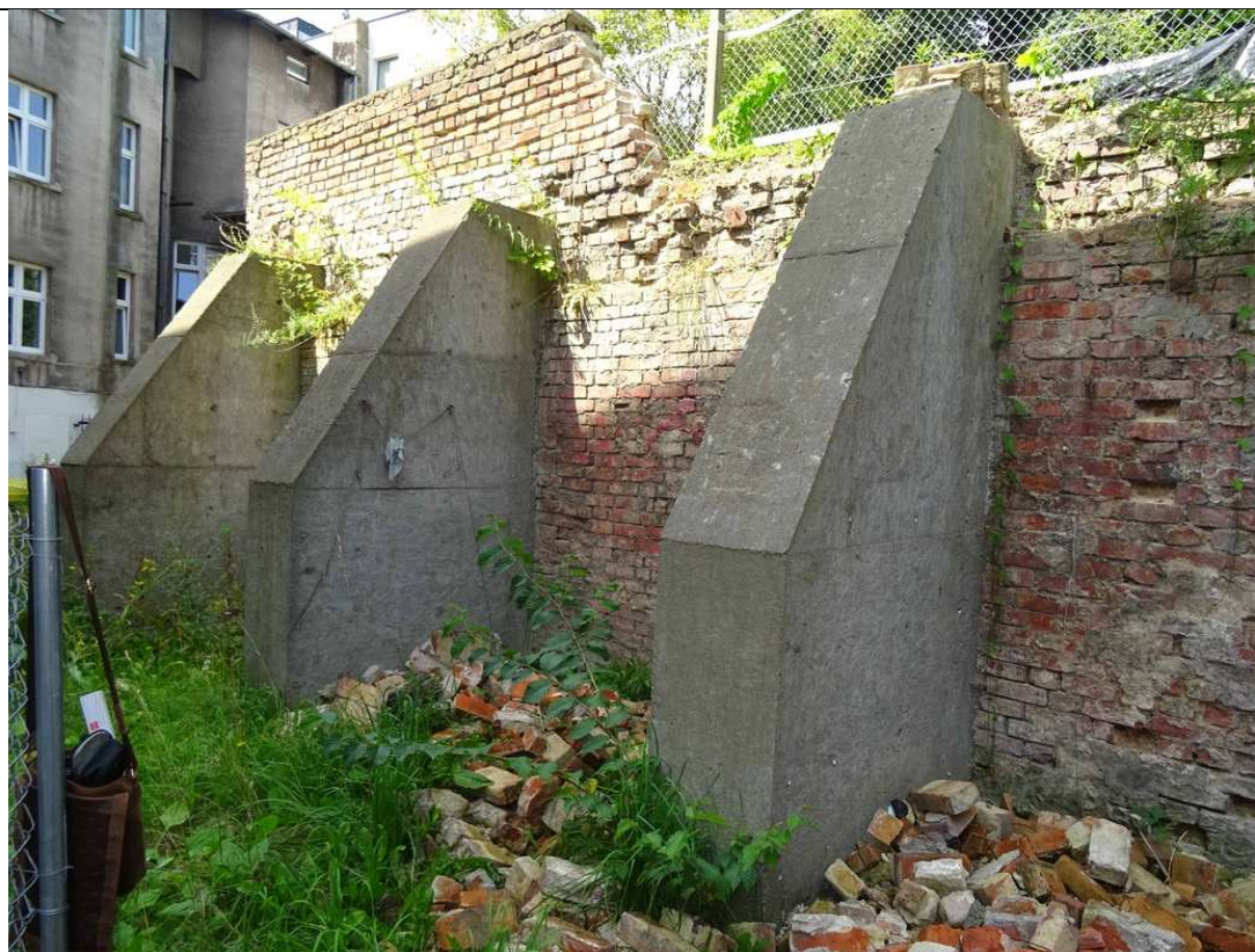
Fot. 3 Widok ogólny muru – odcinek B-C. Widoczna zniszczona partia muru, widoczne również strefa znaczne zniszczenie cegieł w pasie na poziomie terenu znajdującego się za murem.
