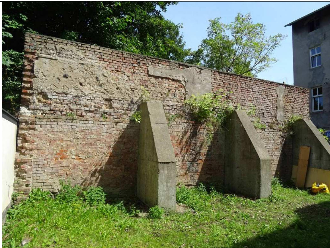
Fot. 2 Widok ogólny muru – odcinek A-B. Z lewej widoczne strzępiał po nieistniejącym budynku. Lico ścian porośnięte roślinnością średnią oraz widoczne wysolenia.
